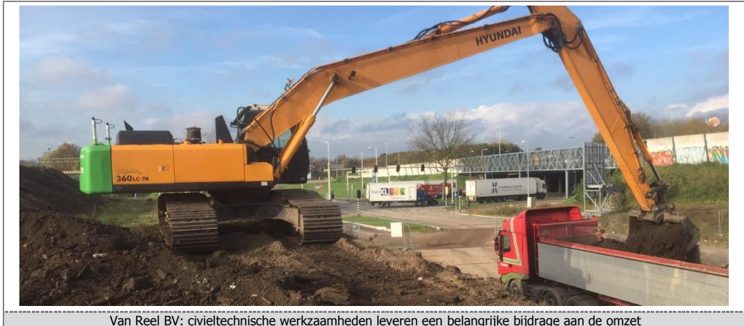
Van Reel BV: civieltechnische werkzaamheden leveren een belangrijke bijdrage aan de omzet
